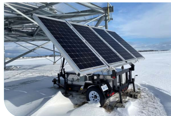
Remorque équipée de panneaux solaires pour la recharge des batteries
